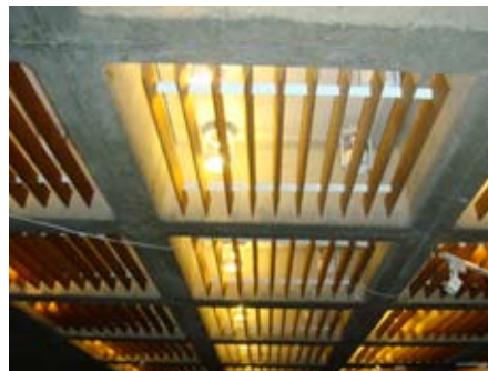
照明が設置されたジャパン・ソサエティーのロビー天井。
